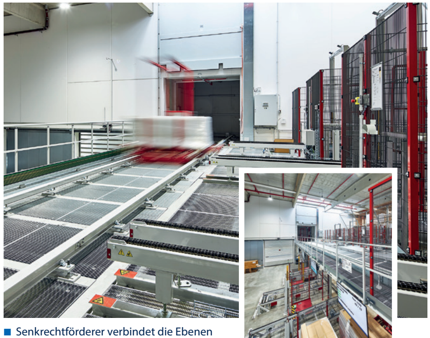
■ Senkrechtförderer verbindet die Ebenen
